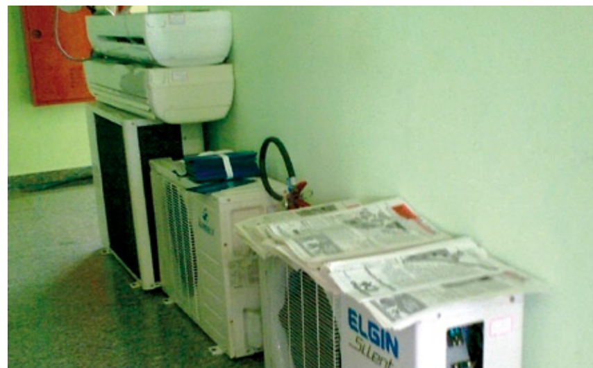
Mostra os aparelhos de ar condicionados
