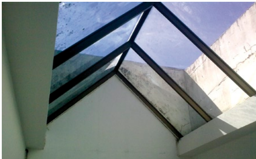
Fotos mostram as trincas no platibanda.
