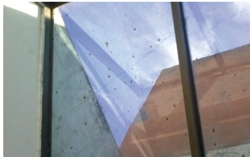
Trincas no vidro da Pérgula da cobertura.
